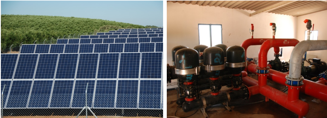
Fig. 11. Generador fotovoltaico (izquierda) y bombas (derecha) en el sistema híbrido fotovoltaico-diésel de Alter do Chão. Hay que notar que el generador fotovoltaico tiene el aspecto de un generador estático, pero en realidad es un seguidor sobre un eje horizontal. Cuanto a las bombas, se puede identificar por el color de la tubería la bomba añadida en el momento de la instalación del sistema fotovoltaico.
